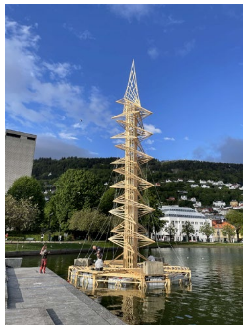
«Connection», en 22 meter høy eksperimentell trestruktur. 13 studenter jobbet i tre uker under motto «It is not an experiment – if you know it will work».
