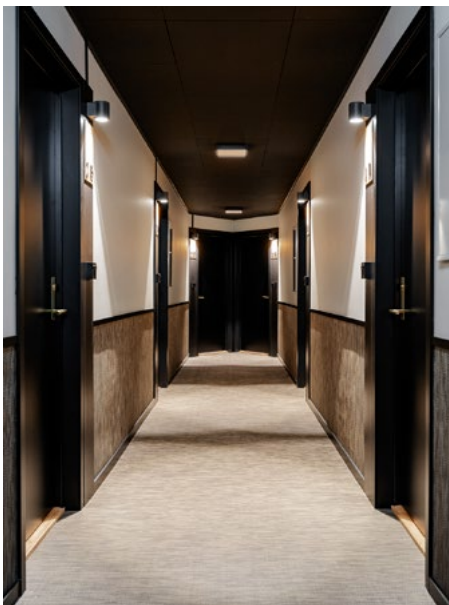
Taklyset er montert på bevegelsessensor, som et energibesparende tiltak. Dekorlampene lyser hele tiden og gjør at korridoren aldri er helt mørk, noe som øker trygghetsfølelse.
