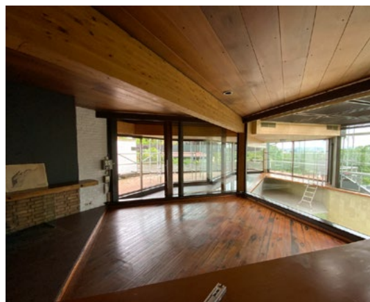
Fra tidligere terrasseinngang mot stue/basseng. Det eksisterende teakgulvet med nating, som tidligere var montert på seilskipet Statsraad Lehmkühl, ble demontert med forsiktighet og er lagret for gjenbruk til egnet prosjekt.
