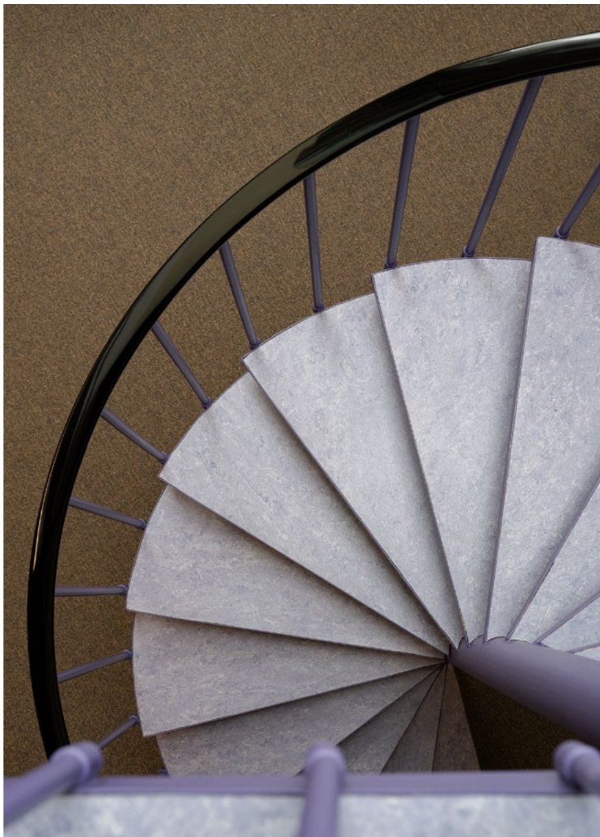
En intertrapp ble funnet innpakket mellom 5. og 6. etasje. Den var fullt brukbar, og den kunne stå der den stod. Å bevare på stedet og gjøre minst mulig med det er det beste miljøtiltaket!
