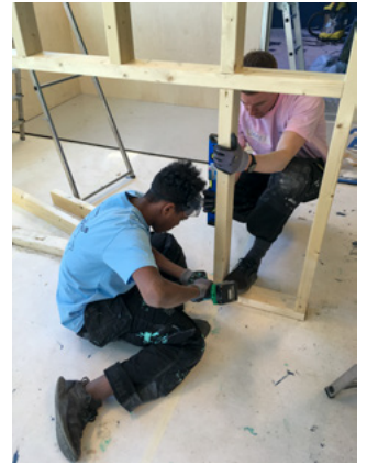
Ungdom og arbeidsleder bygger en av skilleveggene sammen. Ungdommen har lært seg å bruke drill for første gang.
